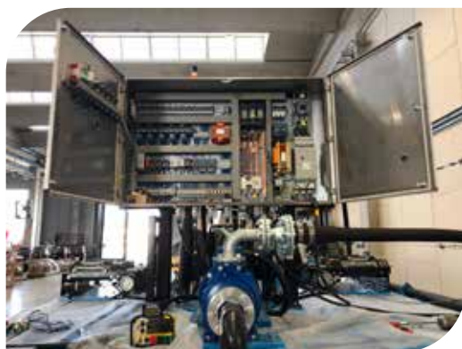
Pannello di controllo elettrico
